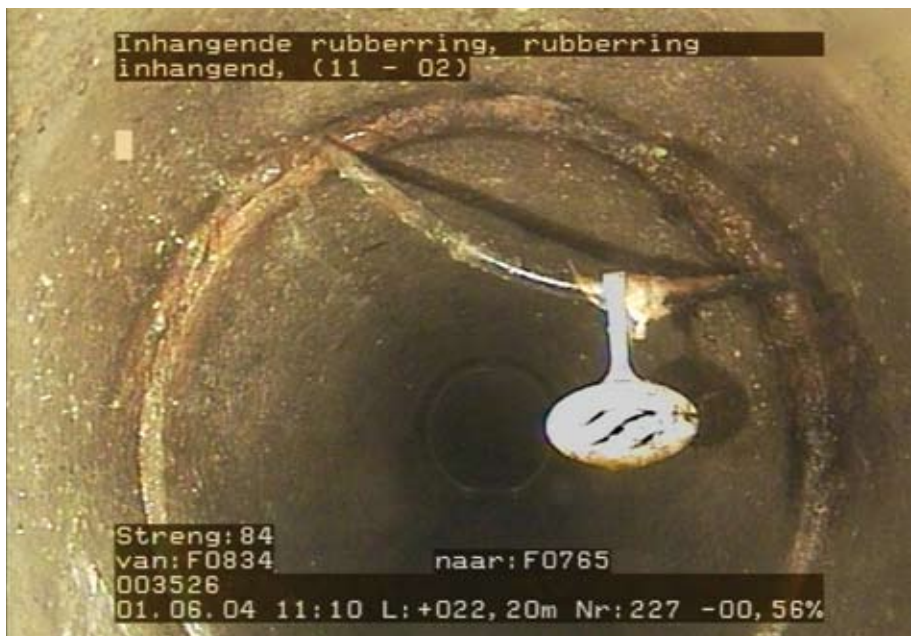
Inspectie van riool: rubberring heeft losgelaten en bij toeval is er een toiletverfrisser aan komen te hangen. Inhangende rubberen ring.
