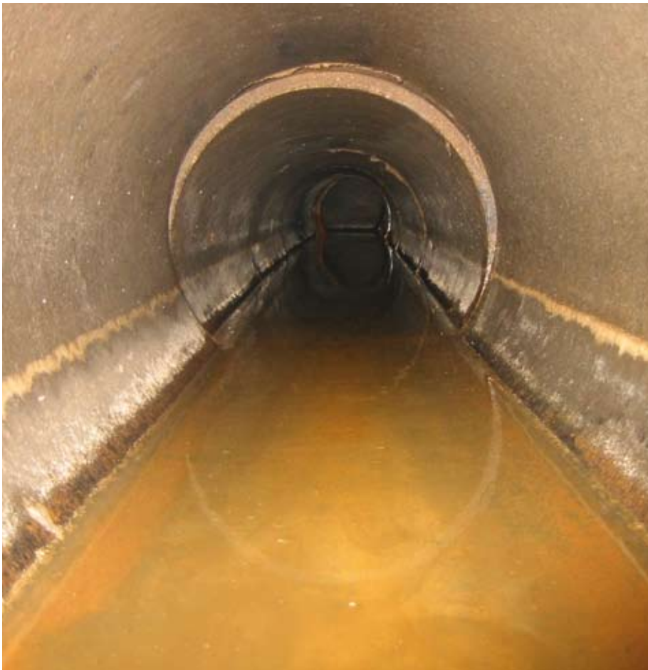
Radiale verplaatsing van twee rioolbuizen, blijkbaar in ruste (vanwege de doorlopende horizontale aftekening boven de waterlijn).
